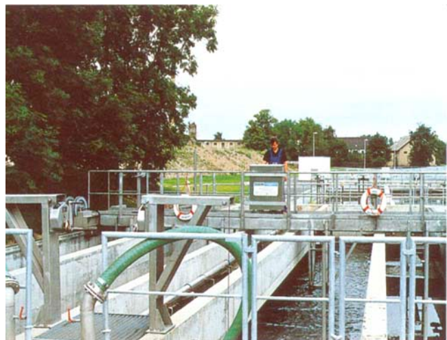
Belüfteter Sandfang mit Ölabscheider
